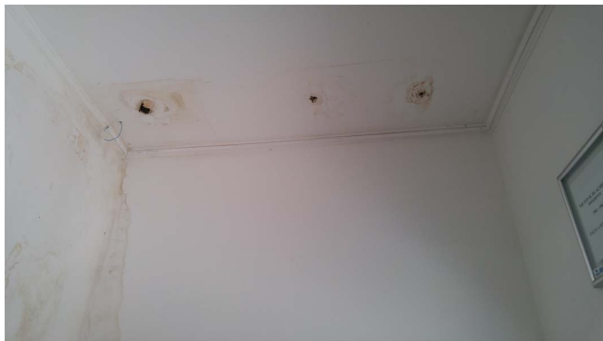
* Teto de gesso com infiltração e danificados
