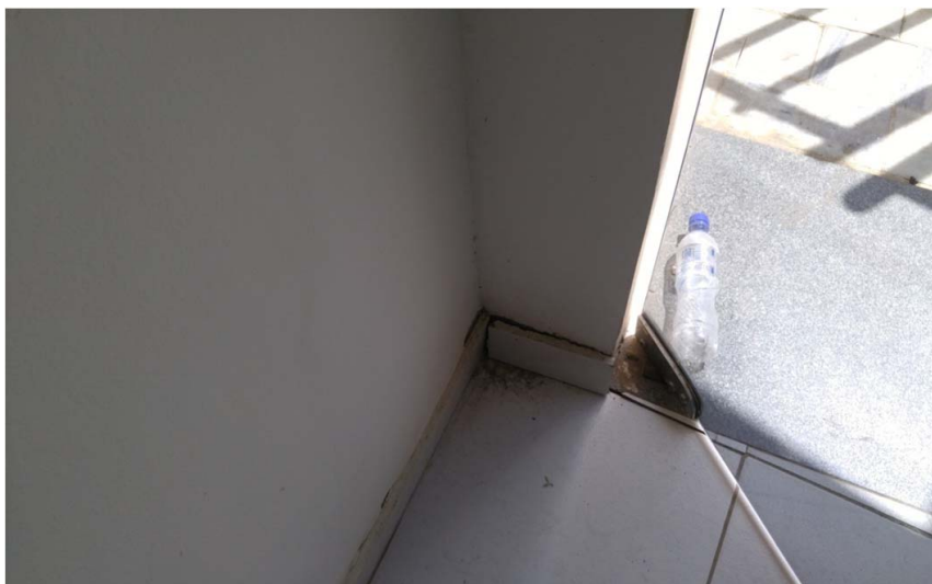
* Porta de vidro da entrada da Câmara e rodapé danificado.
