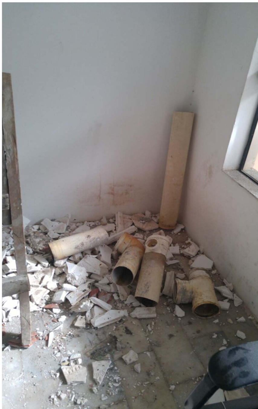
* Tubulação com vazamento.
