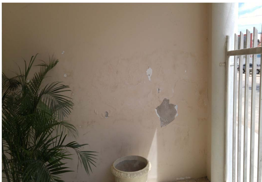
* Paredes do pátio da Câmara com infiltração.
