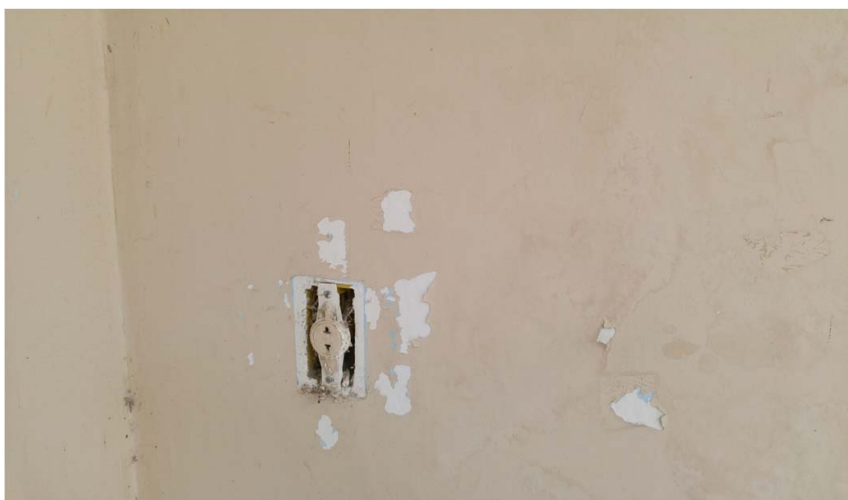
* Interruptores do pátio da Câmara expostos;
