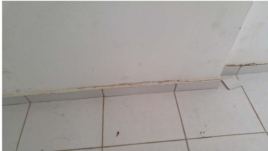
* Rodapé de paredes quebrados.
