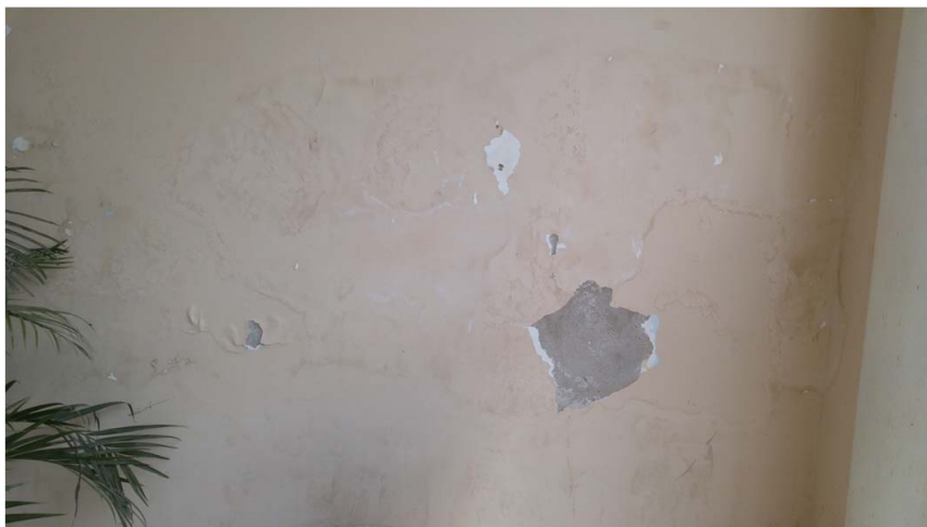
* Paredes do pátio da Câmara descascadas.
