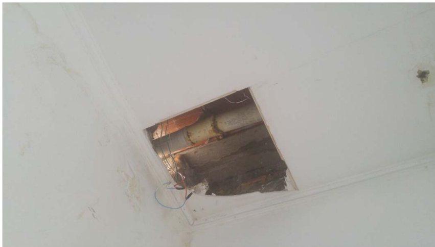
* Tubulação do esgoto entre a laje e o forro.
