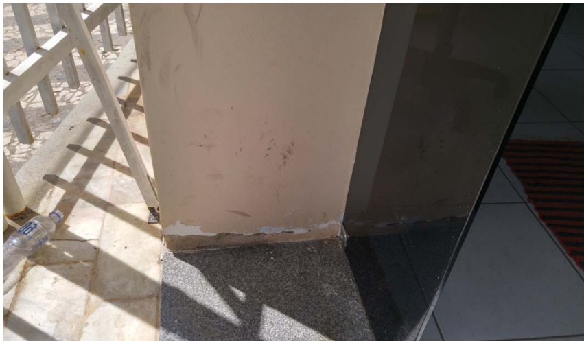
* Paredes da entrada principal suja e descascando.
