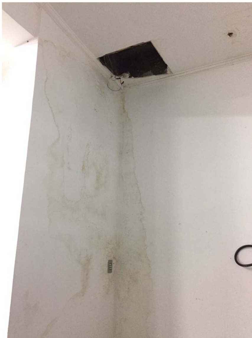
* Paredes com infiltração e teto de gesso quebrado.
