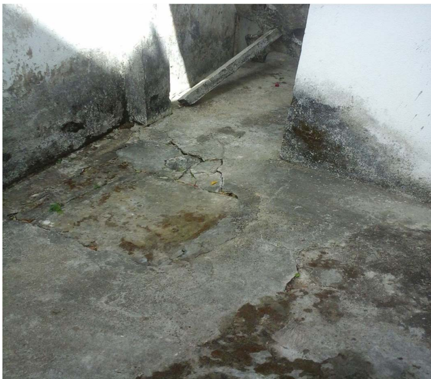
* Piso da parte externa quebrados (quintal).
