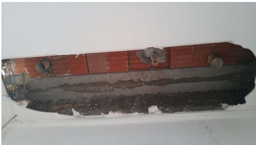
* Vazamento do banheiro do gabinete da presidência.
